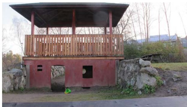
Hårt slitage på gräsytor vid paviljongen
