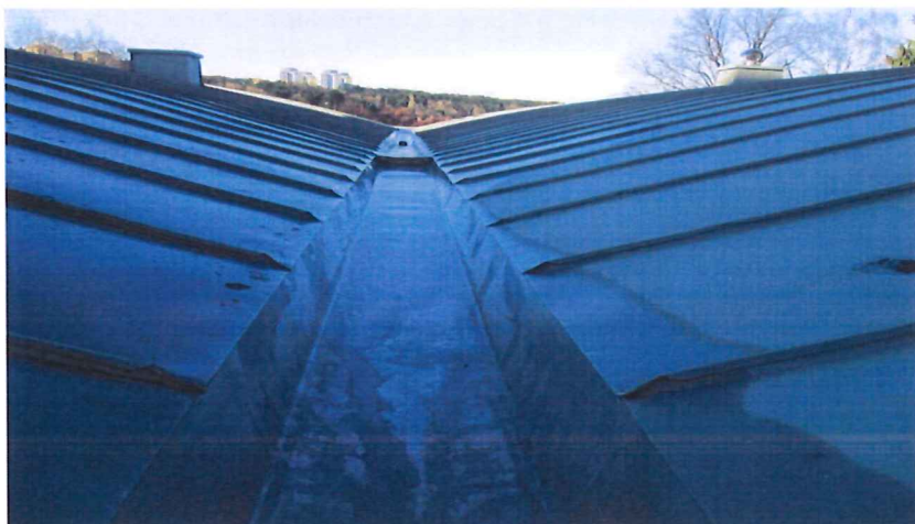
De befintliga takrännorna uppvisar ett stort antal sprickor
