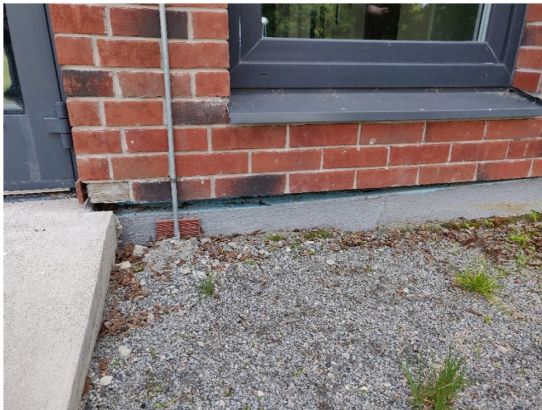
Skador på grundkonstruktion på grund av marksättningar.
