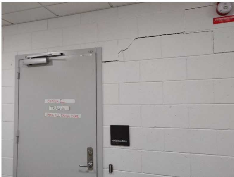
Sprickor i väggar i omklädningsrum.
