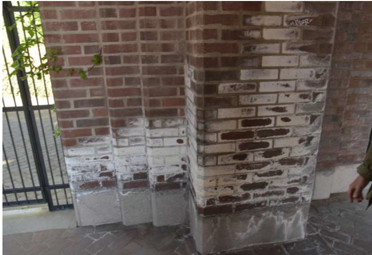
Omfattande saltutfällningar orsakade av igensatt takavvattning.
