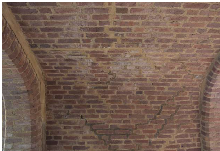
Saltutfällning och urlakad fog i valv under västra läktaren, orsakade av felaktig avrinning. Notera även sprickan mot valvbågen till vänster och felaktigt utförda lagningar.
