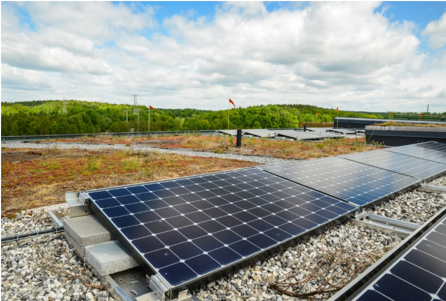
Bild 2. Kombination av gröna tak och solceller på fastigheten Stora Sjöfallet i Norra Djurgårdsstaden.
