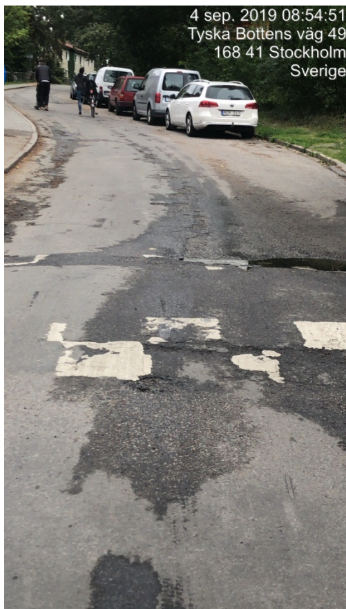
Figur 1. Potthål och sprickbildningar
