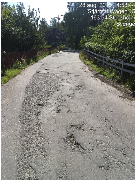
Figur 8. Potthål, sprickbildning och spårbildning
