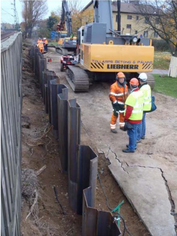
Figur 4: Spont utmed Västkustbanan i Furet, Halmstad
