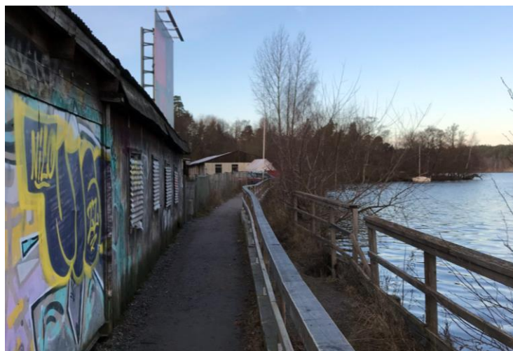
Foto på befintlig strandpromenad som är avsmalnad eftersom yttre delen har betydande sättningsskador.
