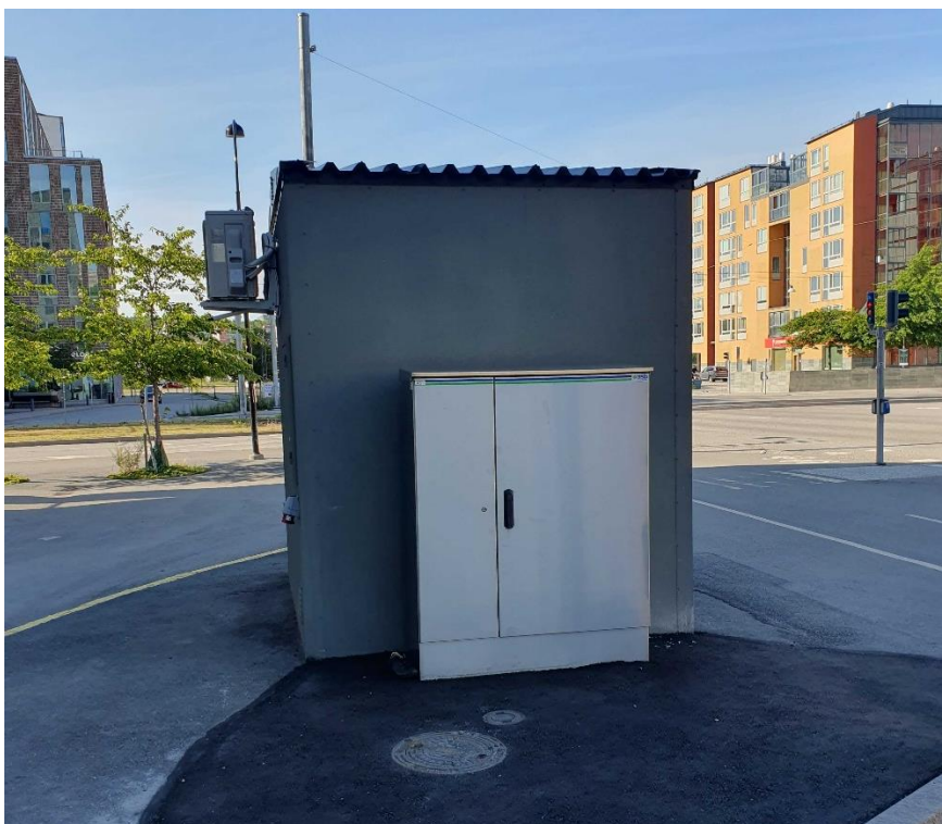
Figur 14. En infiltrationsanläggning och tillhörande infiltrations-skåp. I skåpet finns styrordning för vattenflöde och el till frostskydd av vattenledningar.
