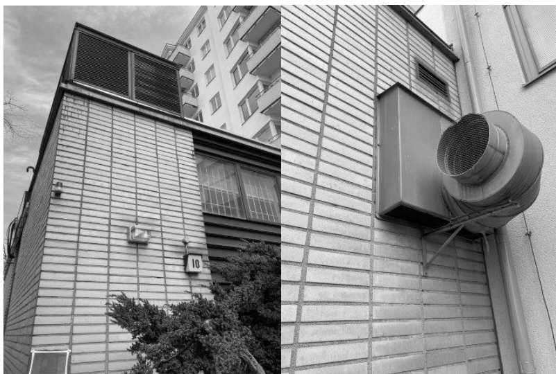
Bild 1, Av-/uteluftsdon och kombihuv vid Syssemansgatan 10
