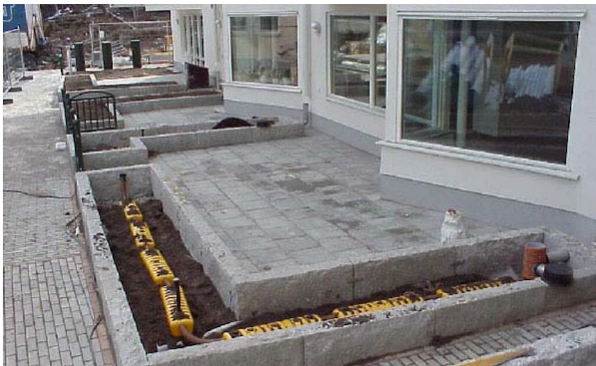
Figur 8c Takvattenutlopp till infiltrationskassetter/spridningsmagasin. Kan tillämpas då direktutledning till omgivande mark inte är möjlig (hus 1). Lösningen ger vattentillskott till planteringsyta, samt ett fördröjande avrinningsförlopp. Anordningen kräver väl-dränerat underliggande material och bräddfunktion.
