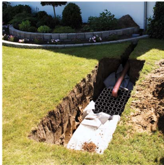
Figur 8b Stuprörsutlopp till kassetmagasin.
