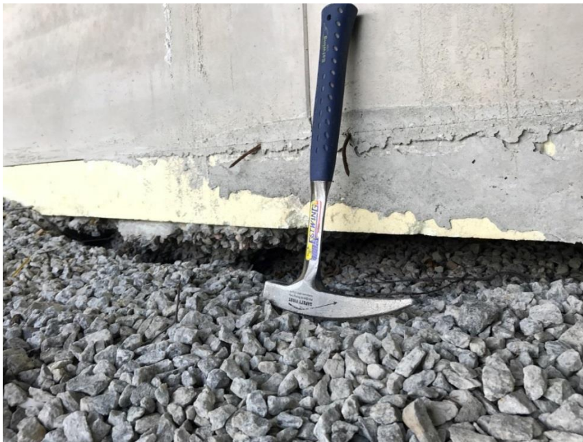
Figur 1. Sättning under vagnhallen.
