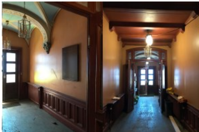
Bostadsentrén klarade sig från brand och fuktskada men är rökskadad. Planförslaget innebär att entrén rivs och att utformningen av en ny entré relateras till befintlig utformning.
