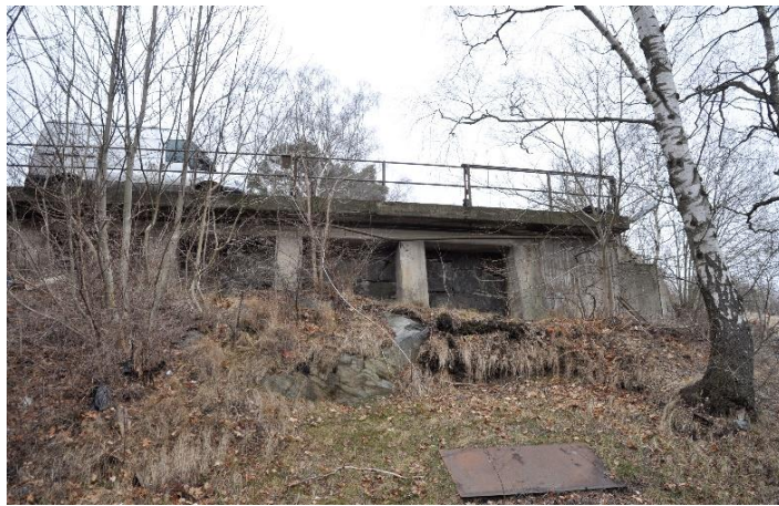
På den högre norra sidan gick tågrälsen. Det finns ännu spår av järnvägens bropelare öster om byggnaden. Järnvägsrälsen gick här på en viadukt in i området.
