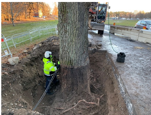
Bild 5 Oskadat rotsystem i den öppnade gropen
