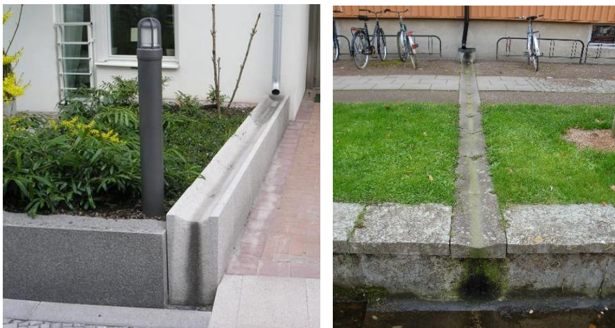
Figur 32. Exempel på stuprörsutkastare i anslutning till rännor (Bild: Sweco).
