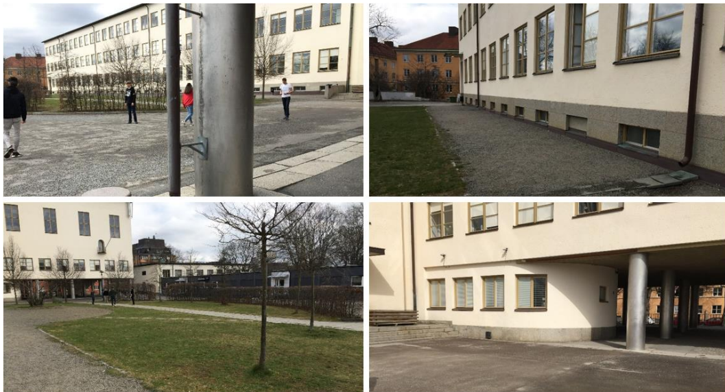
Figur 3. Befintlig skolbyggnad med skolgård. Takdaggvatten leds i stuprör på skolans södra fasad och vidare i rännदार mot gräsyta på skolgård (övre höger bild).
