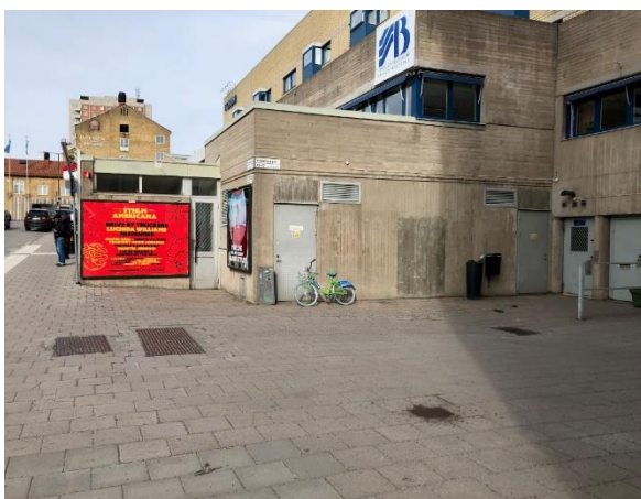
Figur 17 Portarna i södra delen av fastigheten ligger i en lågpunkt och dagvatten riskerar att ansamlas här och ledas in i byggnaden
