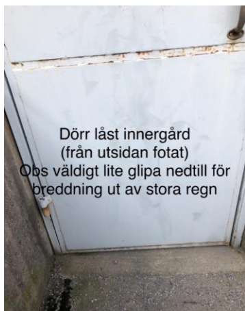
Figur 16 Port på fastighetens östra sida kan släppa ut små mängder dagvatten när porten är stängd
