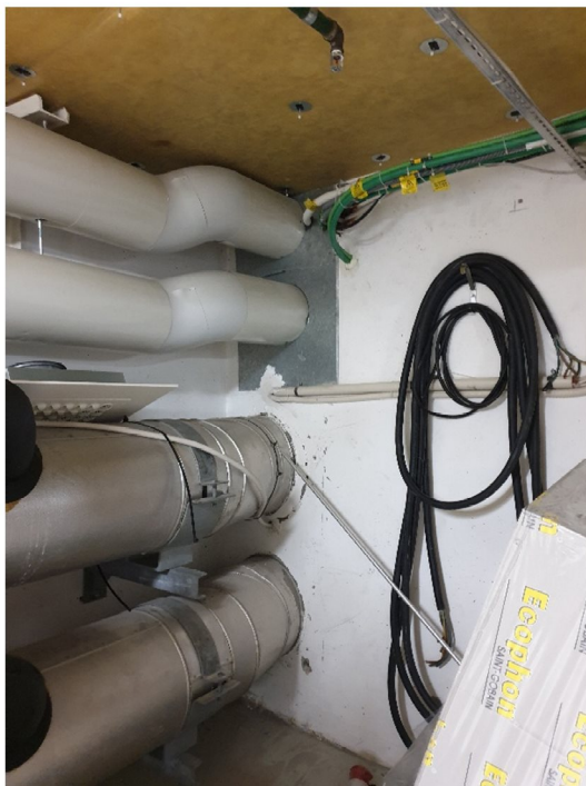
Bild 5. Inkommande fjärrvärme, fjärrkyla och fiber.
