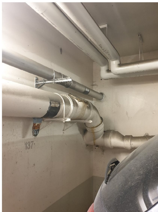
Bild 3. Utgående spillvatten Björkhallshuset
