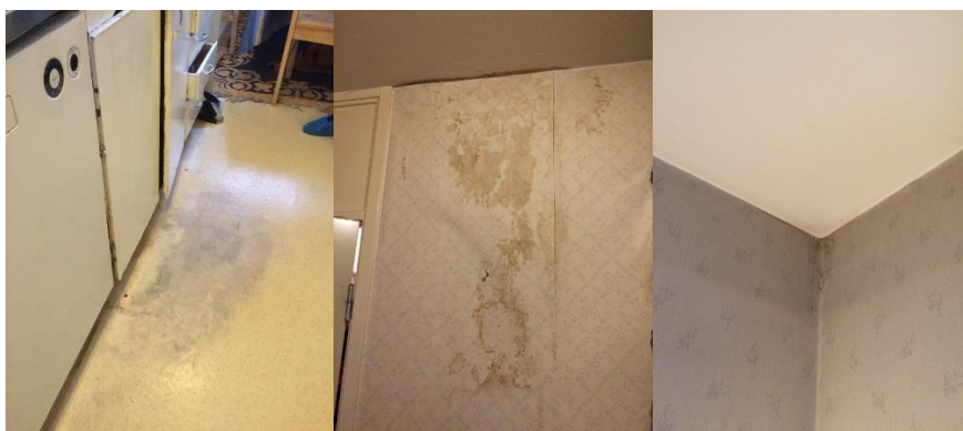
Exempel på fuktskador i en fastighet i Vårberg som noterades i samband med bostadstillsynen.
