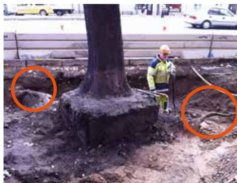
Pipelinerötter som blottagts vid schakt.
