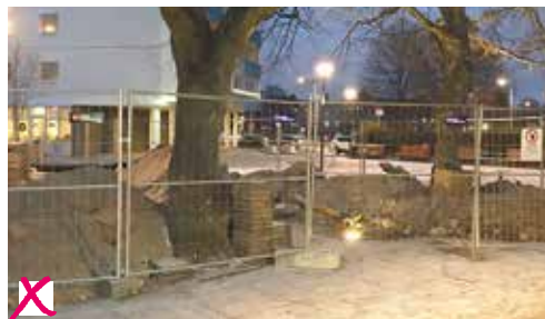
Ingen avspärning: upplag och entreprenadstaket inom rotzonen.
