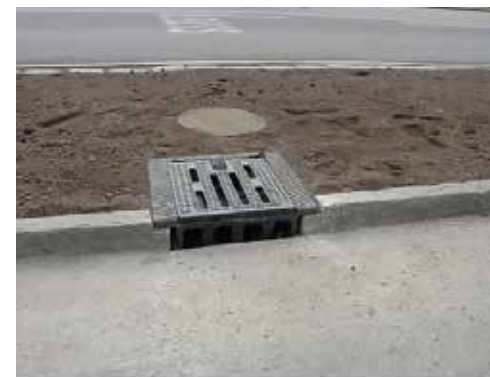
Brunnsbeteckning med sidointag.
