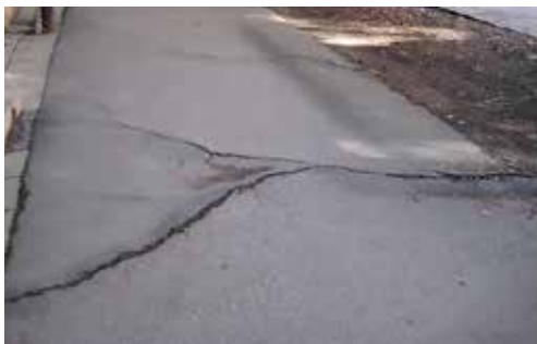
Skador på beläggning orsakade av rötter.
