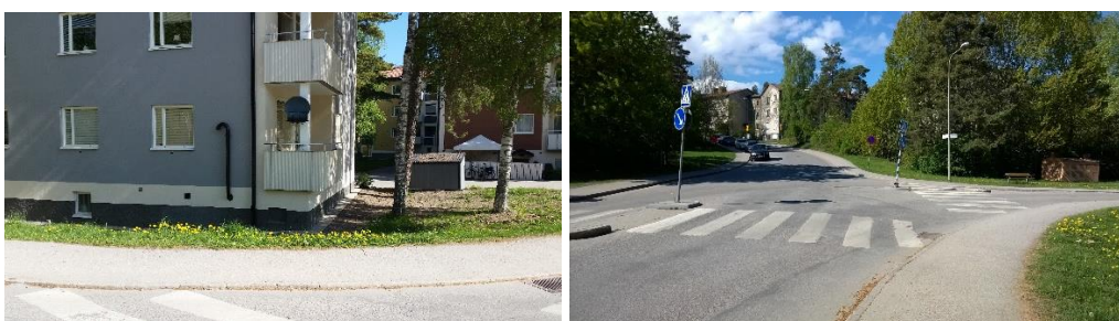
Figur 3 Korsningen Viskagränd-Bergsrådsvägen. Vänster bild: gatan ligger högre än husens källarplan. Höger bild: transformatorstationen står i ett flackt område som ligger lägre än gatan. Foto maj 2017.
