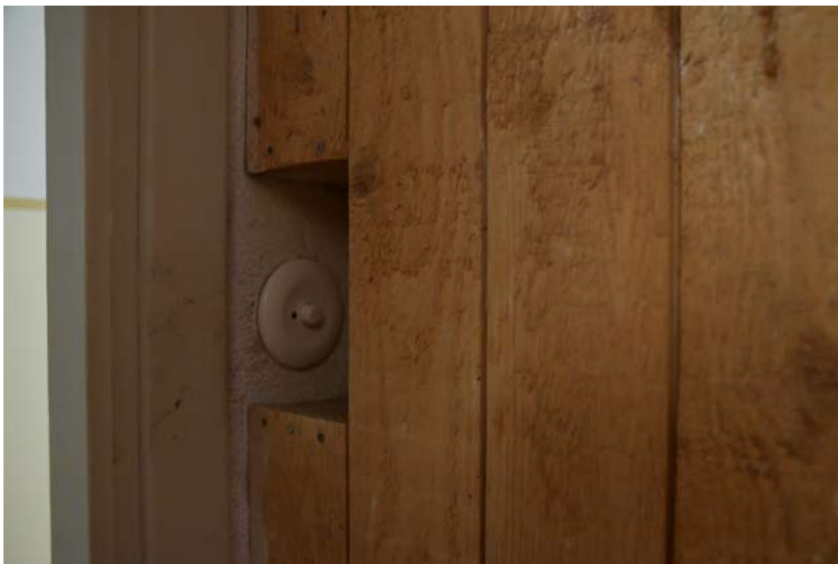
I matkällaren har inredningen anpassats så man kan nå strömbrytaren.
