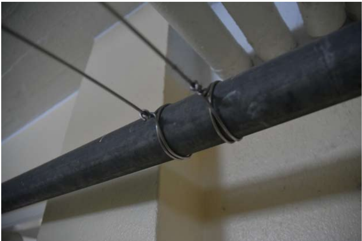
Detalj i torkrummet med torklinor i rostfri wire.
