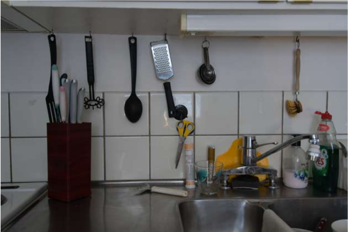
TVå rader kakel över diskbänk och spis var standard i 1950-talets genomarbetade köksinredningar. Kaklet är satt med mörk fog och den övre raden har rundad kant uppåt. Blandaren är sekundär, liksom lysrörsarmaturen.
