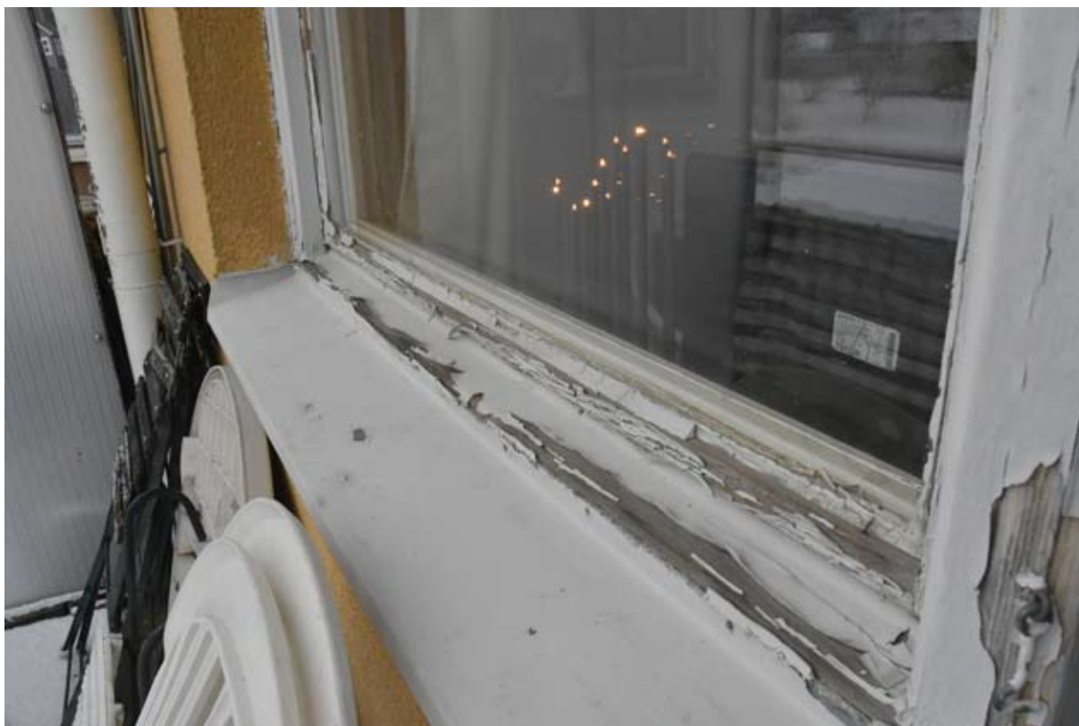
Exempel på fönster i behov av målningsunderhåll.
