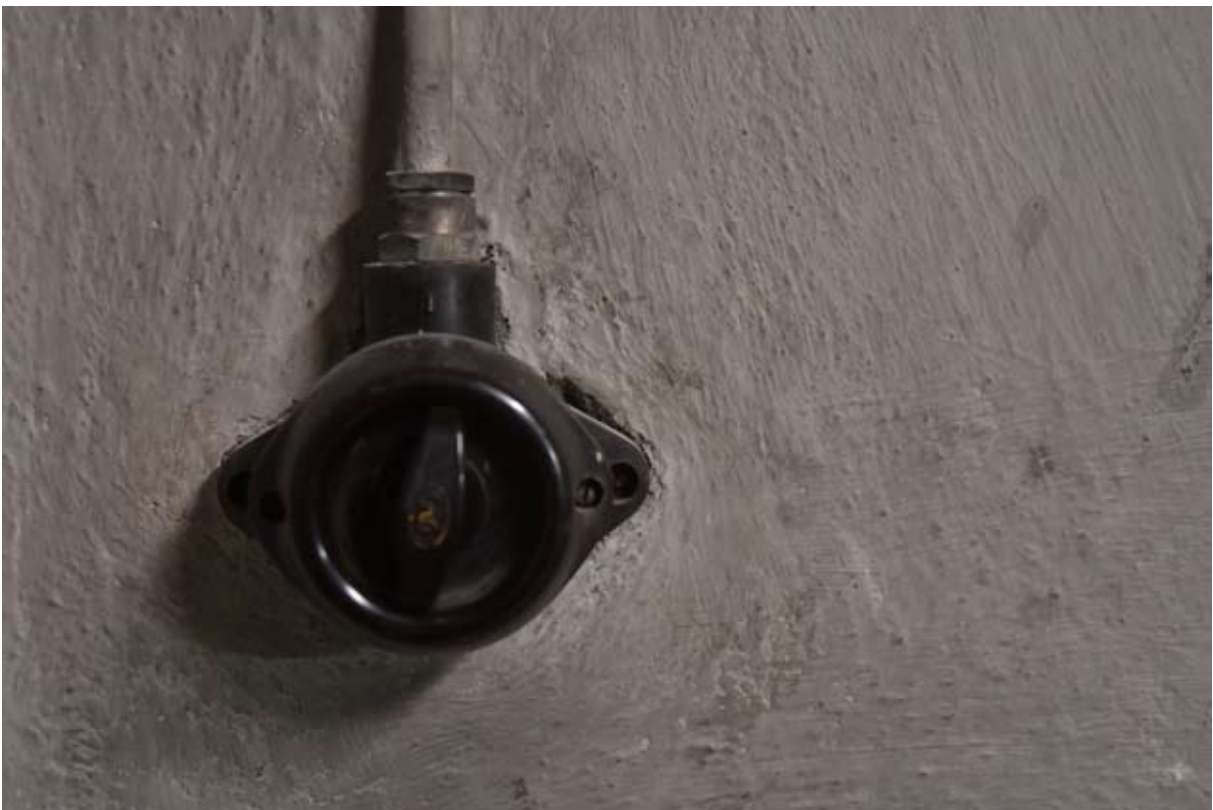
Äldre vred till belysningen i källaren.
