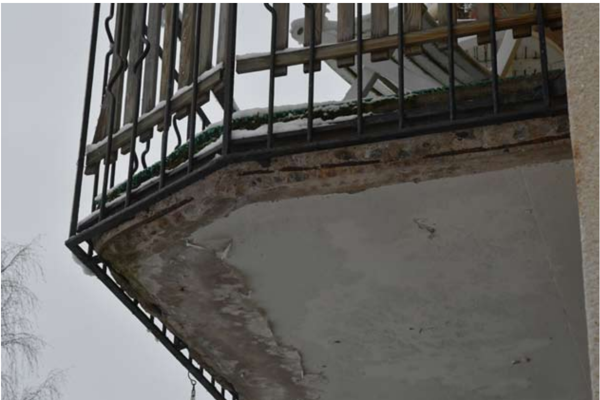
De smäckra balkongerna har karbonatiserad betong och begynnande korrosion på armeringen. Plattorna behöver bilas bort och gjutas om.
