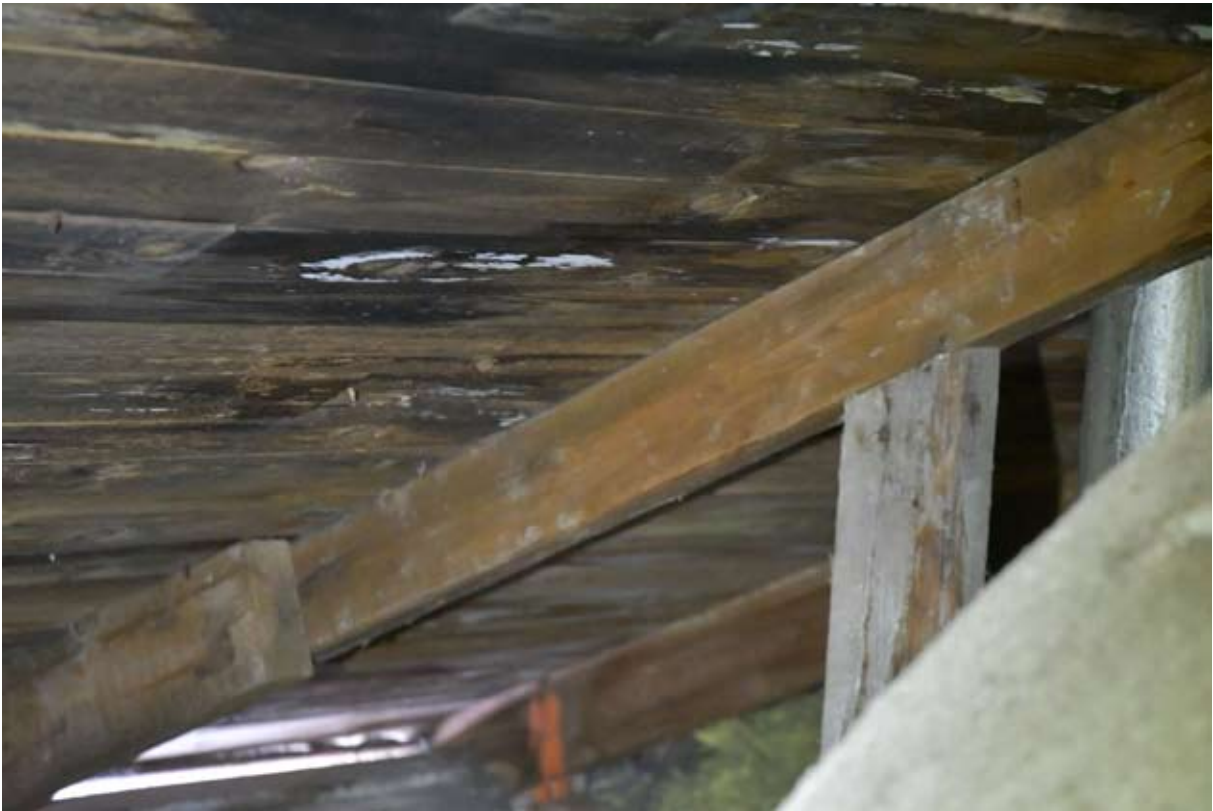
Pga läckage i taket så är underlagstaket ställvis skadat och behöver bytas. Takstolarna ser dock ut att vara i gott skick.
