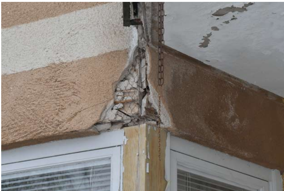
Burspråkens fasader är reveterade, putsen är ställvis skadad, men annars i gott skick.
