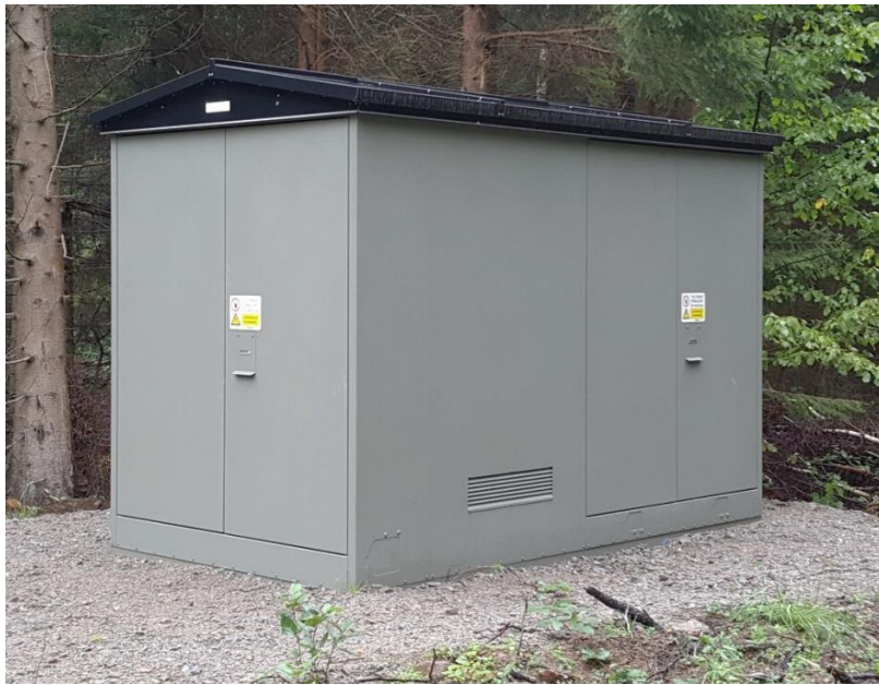
Bild: Exempel på nätstation, Boverket.
