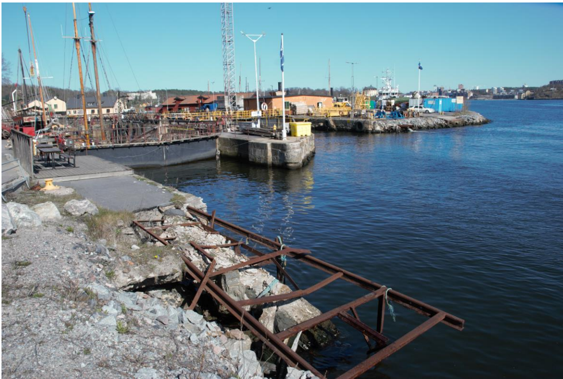
Figur 12. Raserade kajer på öns södra sida vid Östra och Västra dockan (Foto: Sweco).
