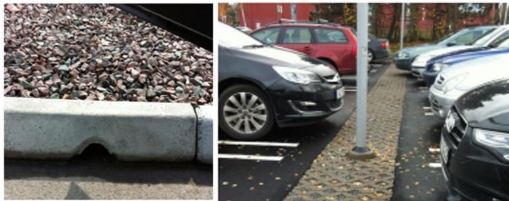
Figur 10. Till vänster: inlopp till makadamdike i kantsten, till höger: raster av betong lagts i överytan på makadamdike. 18
