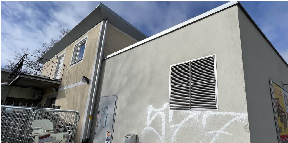
Figur 3 Balkongen ovan värmepumpen minskar nivån till påbyggnaden med minst 10 dB.
