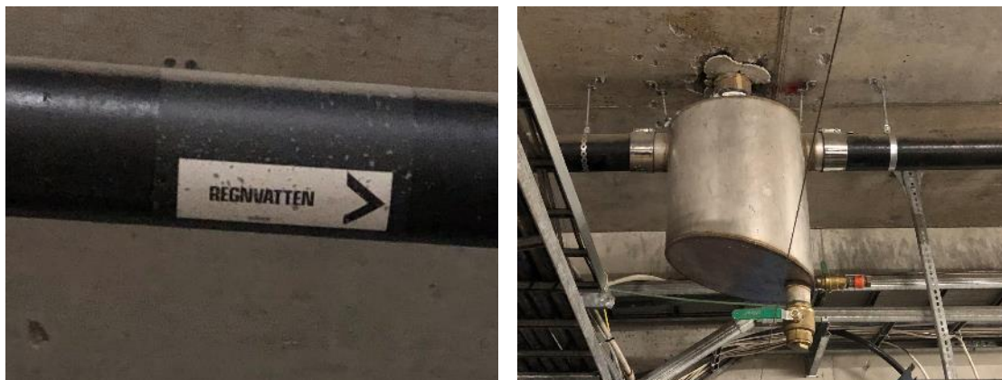
Figur 6. Dagvattenledning i garaget märkt "regnvatten" t.v. och förmodat sandfång t.h.
