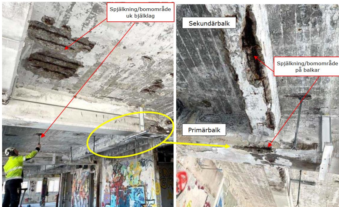
FIGUR 6. URKLIPP FRÅN BILAGA 2 SOM VISAR KORROSIONSSKADOR I KONSTRUKTIONEN.
