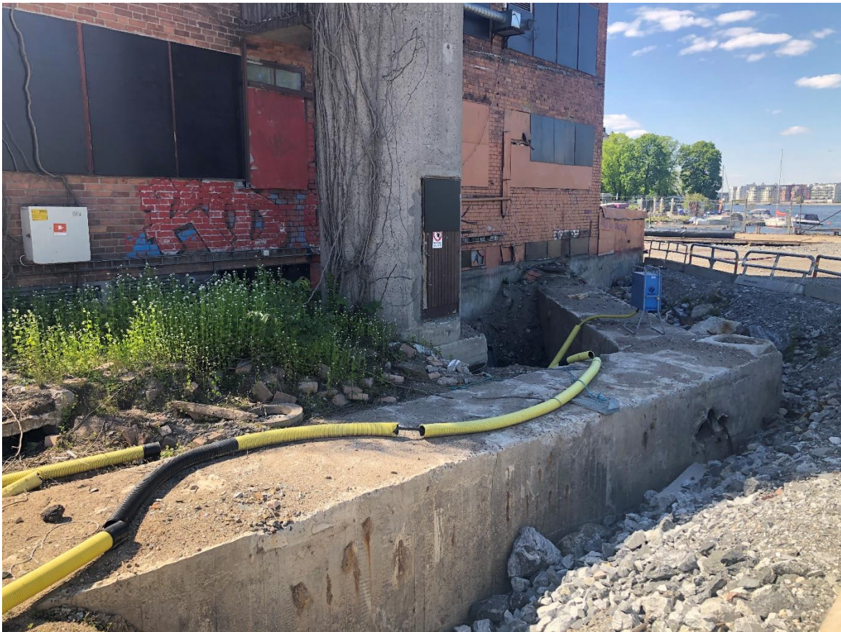
FIGUR 3. KULVERT ÖSTER OM NITROLACKFABRIKEN MED FÖRORENAD JORD UNDER SAMT PÅ DJUPET I YTAN MELLAN FASADEN OCH KULVERTEN (FOTO TAGET JUNI I 2022).
