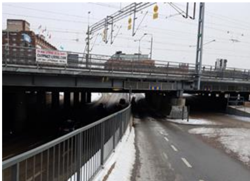
Järnvägsbron sedd från väster, den nedsänkta körbanan för biltrafik till vänster, cykelbana i mitten och gångyta till höger.
