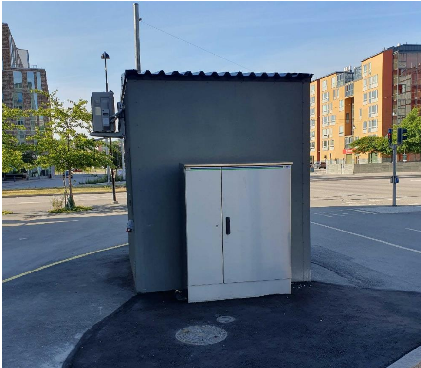
Figur 14. En infiltrationsanläggning och tillhörande infiltrationssskåp. I skåpet finns styrordning för vattenflöde och el till frostskydd av vattenledningar.
