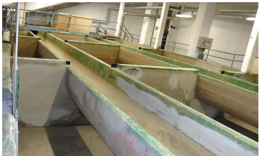
Sandfilterbassänger för rening av vatten
