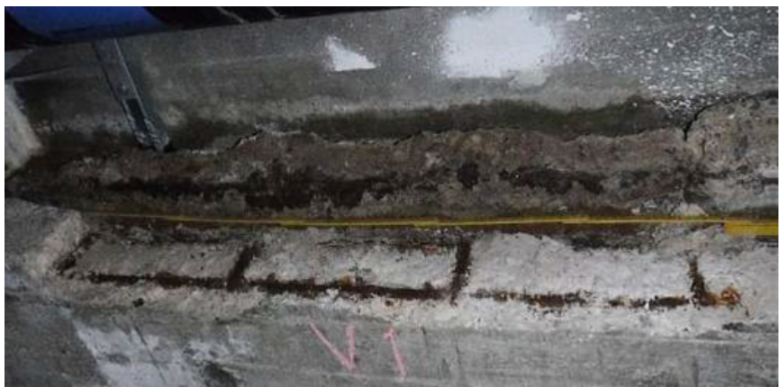
Spjälkskador i betong vid sargen runt 50 meters bassängen.
